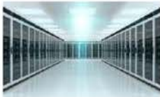
Grandes salas de servidor
